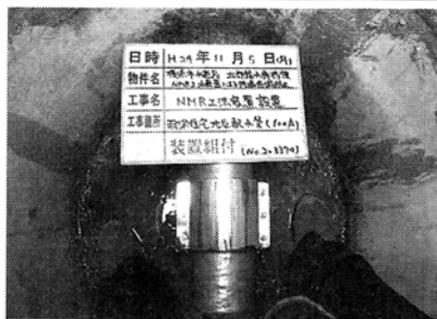
NMRパイプテクターを配備
