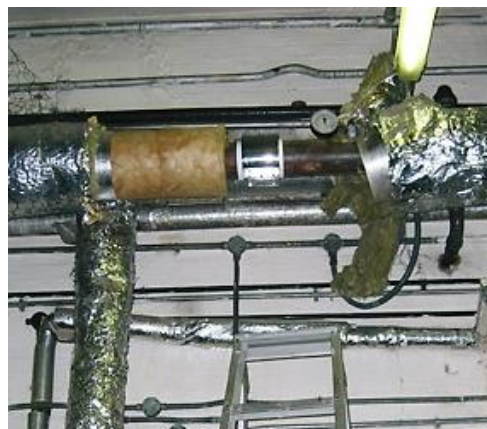
C 棟内給湯配管 PT-100DS
