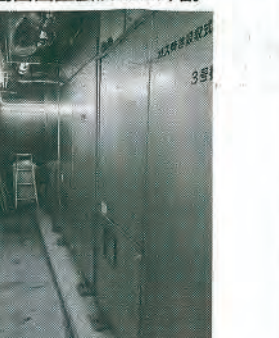
機械室の吸収式冷温水発生器群
