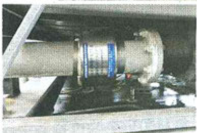
屋上の冷却水配管に設置①と地下機械室の冷温水配管に設置された「パイプテクター」
