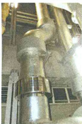
屋上の冷却水配管に設置①と地下機械室の冷温水配管に設置された「パイプテクター」
