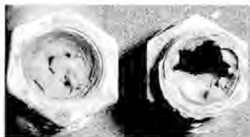
継手部時 築22年・7階建て・26戸（VLP使用物件）
