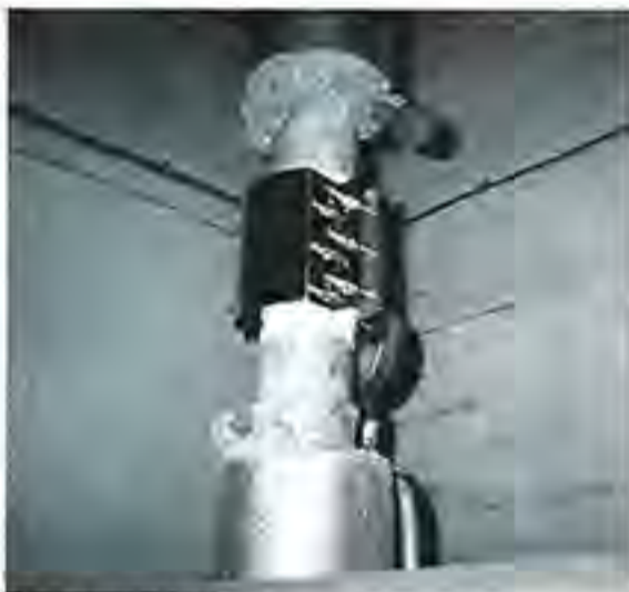
設置箇所 給湯配管
