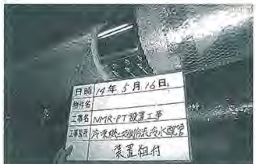
写真4 NMRパイプテクター設置配管
