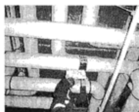
吸収式冷温水発生機二次側 冷温水往管 PT-200DS 各1セット
