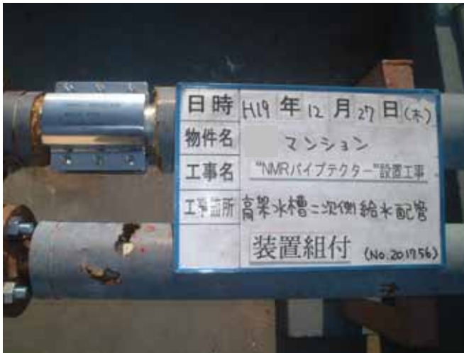
高架水槽二次側 PT - 50DS
