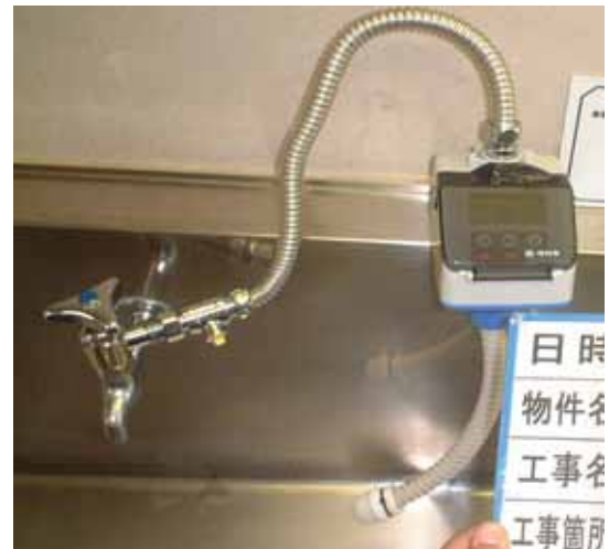
電磁弁設置写真 着色確認の為のフィルター設置
