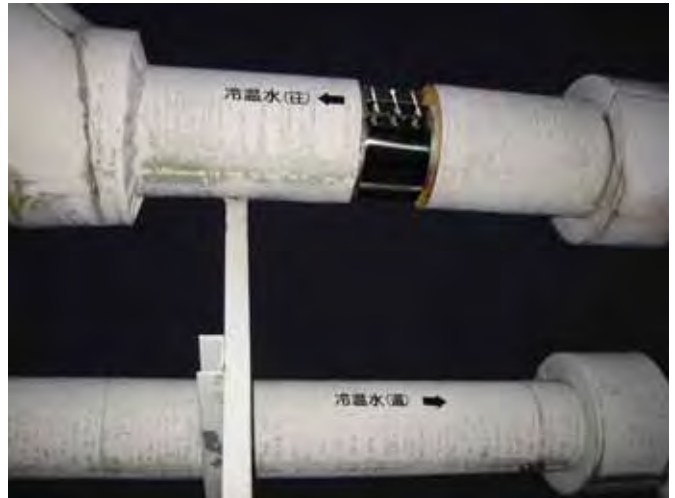
冷温水発生機二次側 PT - 150DS
