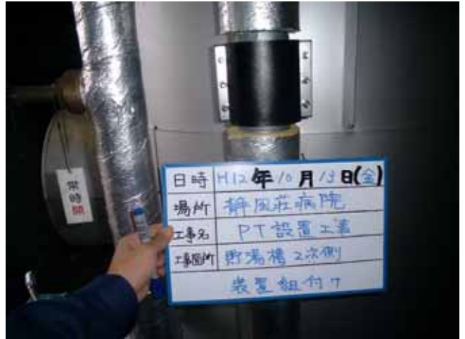
貯湯槽二次側 PT - 75D
