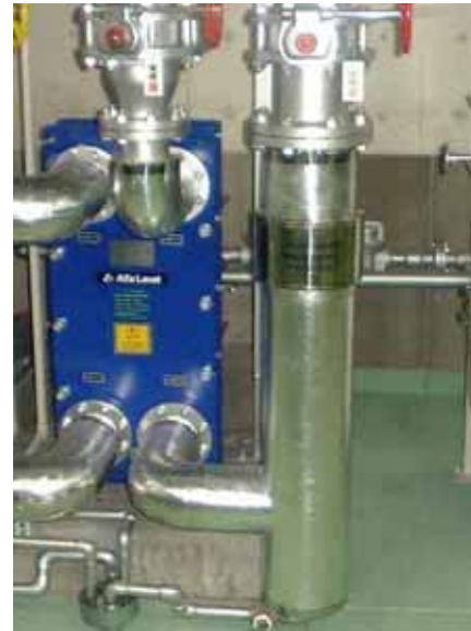
熱交換機2次側 冷温水配管 PT - 150DS
