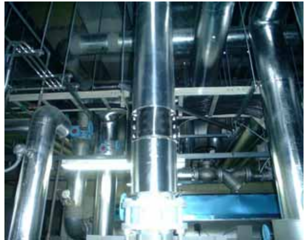
温水ポンプ2次側配管 PT - 125DS
