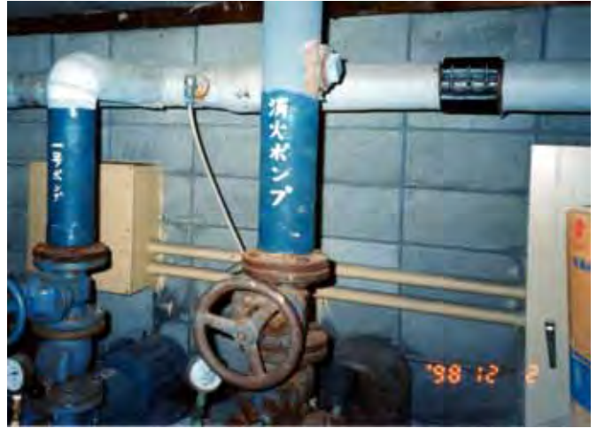
揚水ポンプ二次側 PT - 75 D
