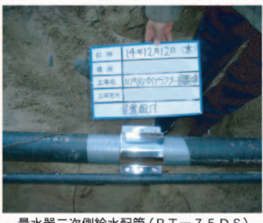
量水器二次側給水管（PT-75DS）
